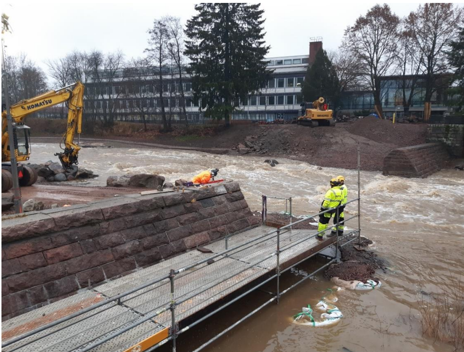
Kuva 2. Tikkurilan vanhan vernissapuristamon padon purkutyö käynnissä syksyllä 2019. Padon reunaosat säästettiin ja viimeisteltiin puretusta osuudesta saaduilla kivillä.
